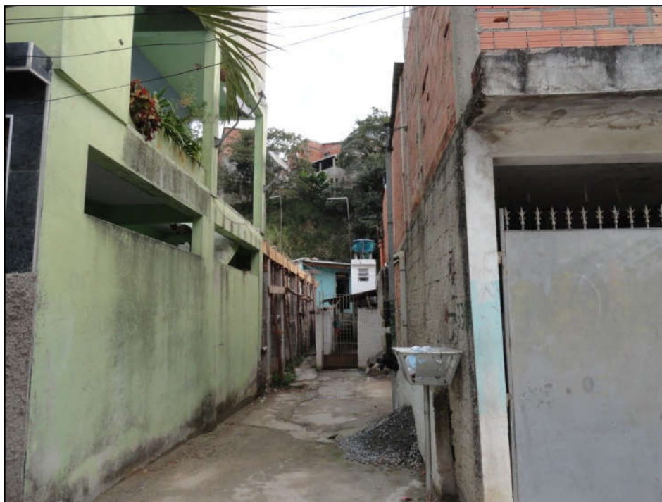
Foto FC-ITA-04-06-02.01: Vista do talude de corte com cicatriz de escorregamento atrás de moradias.
