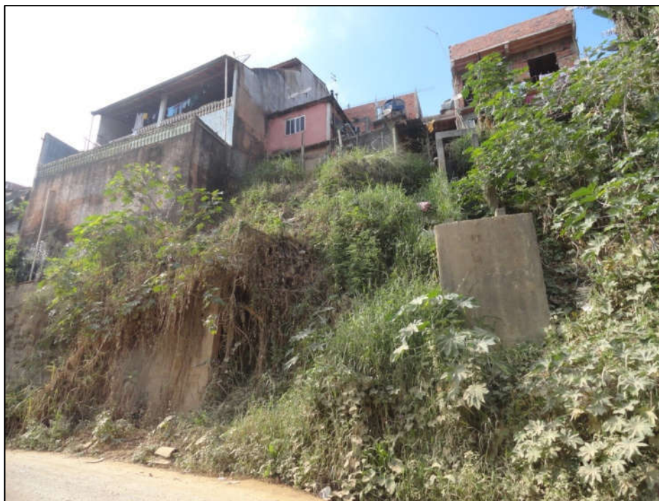
Foto FC-ITA-04-02-02.01: Vista de um trecho do setor com moradias de bom padrão construtivo mostrando muros de contenção e escada d'água, ambos necessitando de manutenção.
