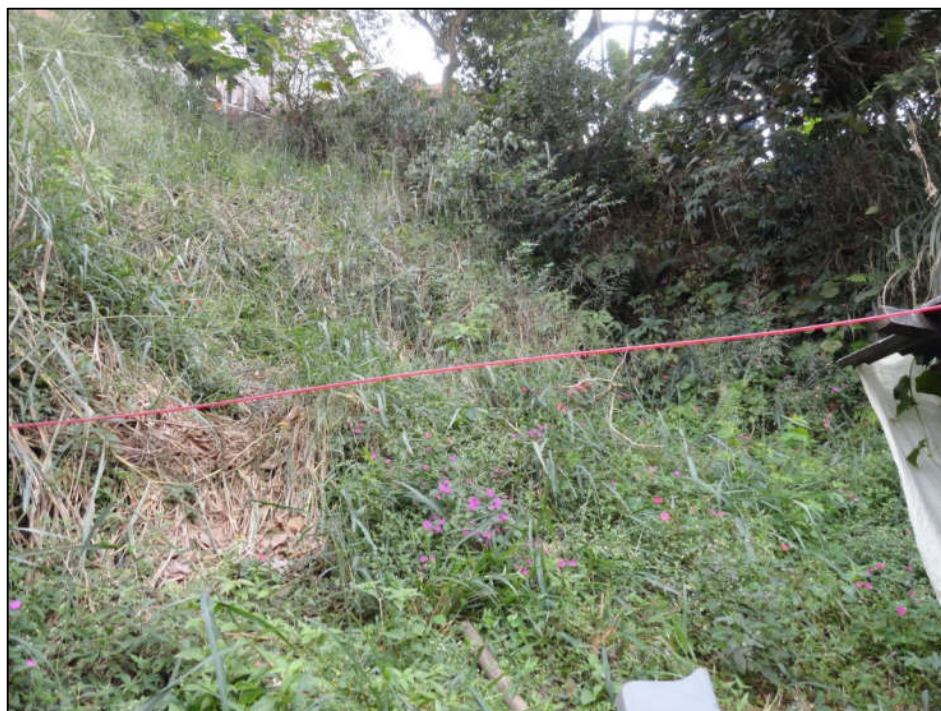
Foto FC-ITA-04-06-02.03: Outra vista do talude de corte e da cicatriz do escorregamento.
