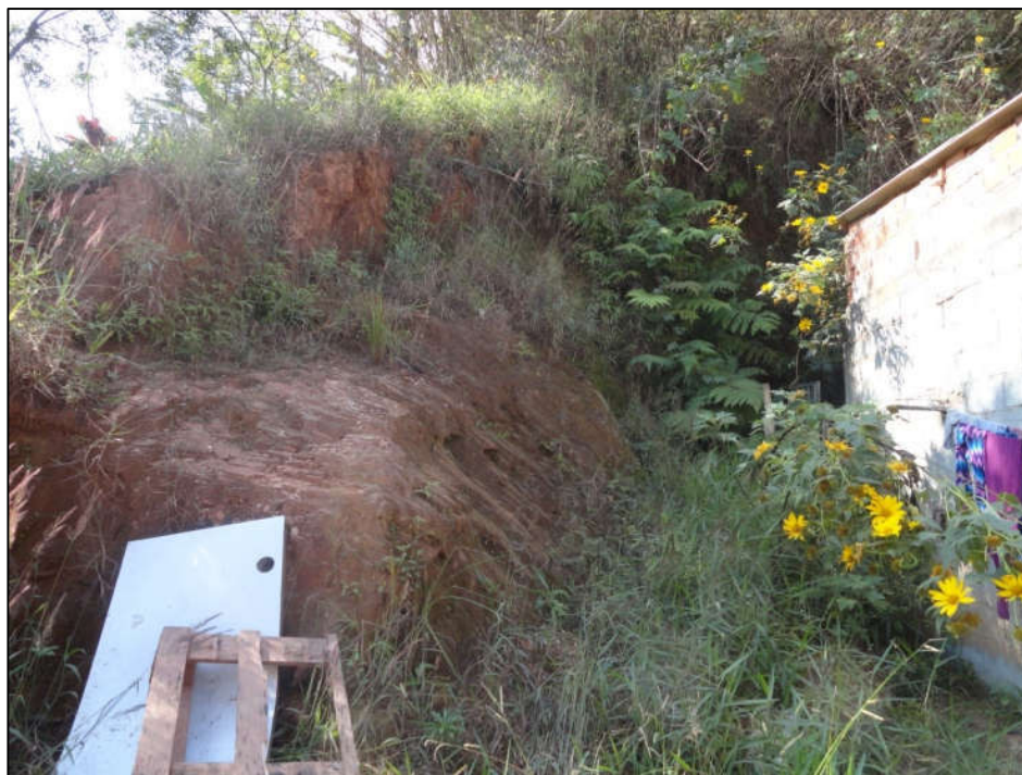
Foto FC-ITA-04-03-02.02: Detalhe da proximidade da moradia com o talude de corte.
