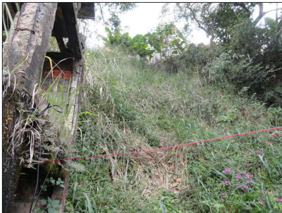
Foto FC-ITA-04-06-02.03: Talude de corte de grande altura e inclinação com a cicatriz de escorregamento.
